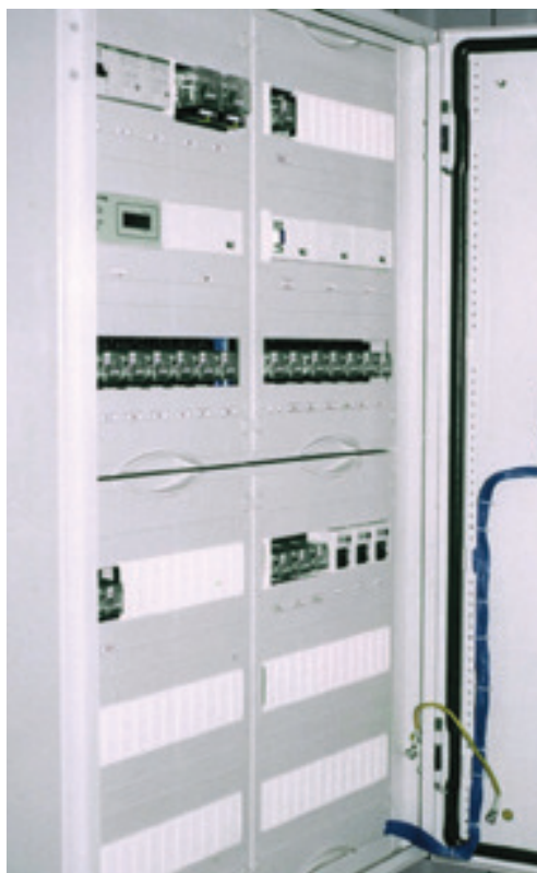
Рис. 15. Шкаф управления, установленный в КТП
